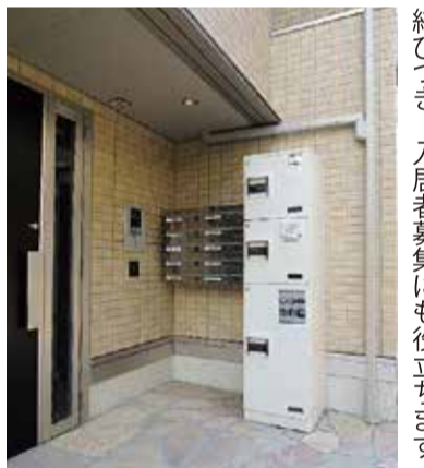
宅配ボックスの設置は物件の差別化に結びつき、入居者募集にも役立ちます
